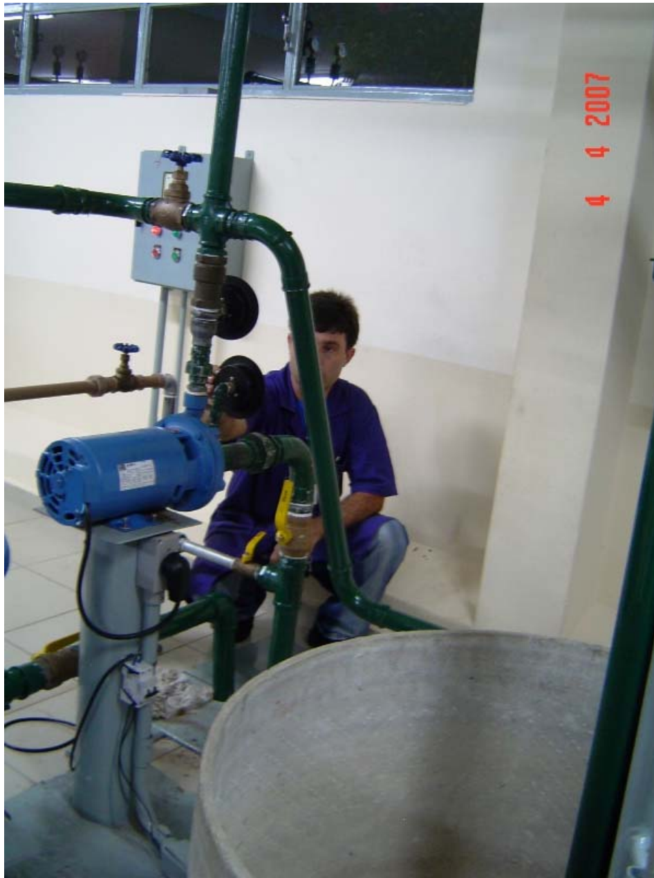
Fernando lendo as pressões manométricas nas seções de entrada e saída da B7
