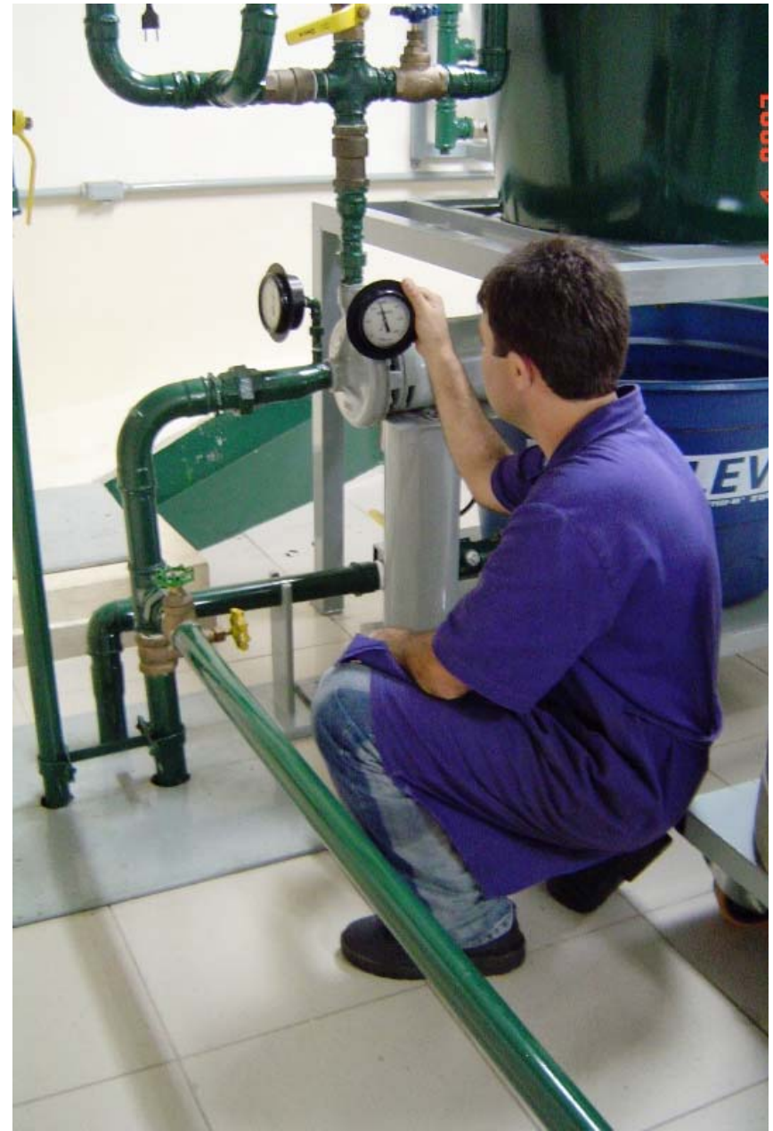
Fernando lendo as pressões manométricas nas seções de entrada e saída da B8
